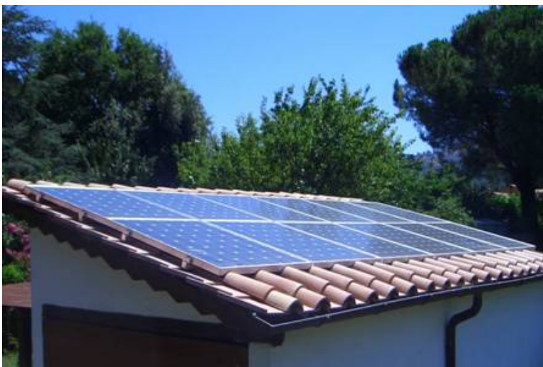
Impianto 2,2 kWp abitazione privata ROMA
